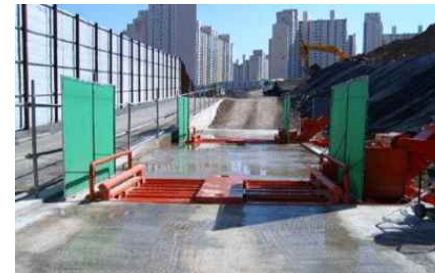
자동식 세륜시설 2단 설치
