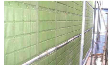
방음시설 설치 [소음 64dB(A)]
