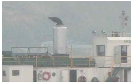
배기연도 및 엔진실, 공기흡입부 소음기 설치 [소음 50dB(A)-200m 거리]
