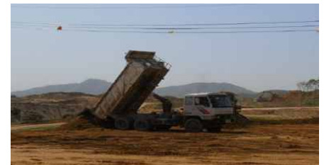
내리기 작업 시 살수 미실시(위반)
