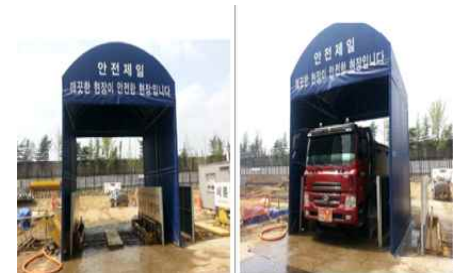
자동식 세륜설비 상단 안개식 스프링클러 설치
