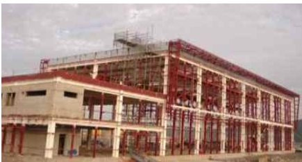
철골 도장작업 시 방진막 미설치(위반)
