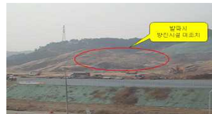
발파 시 방진시설 미설치(위반)
