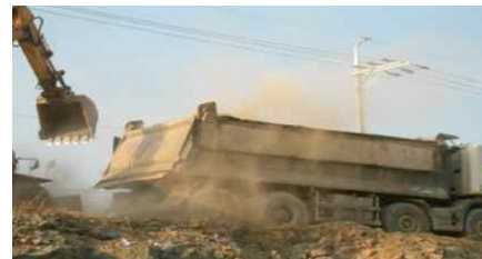
실기 작업 시 살수 미실시(위반)
