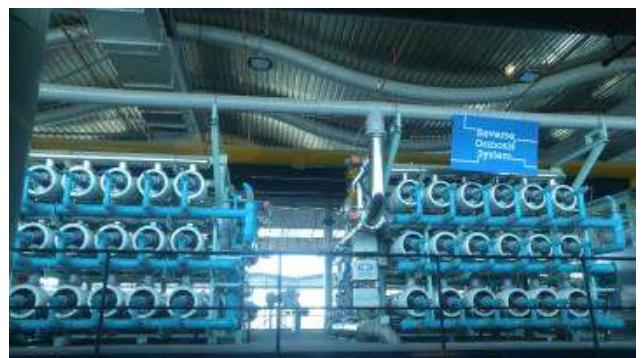
역삼투 시스템(Reverse Osmosis System)
