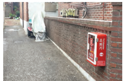
협소한 골목길 내 화재안전시설 배치
